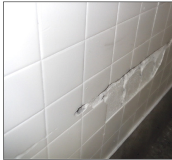
〈벽_도기질타일(충격에 의한 파손)〉
