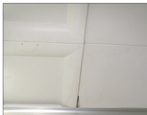
〈이음부분 틈새 발생 및 파손〉
