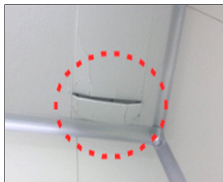
〈텍스에 방수페인트 시공 후 파손〉
