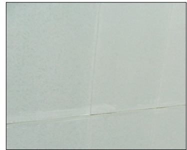
〈시공 불량에 의한 틈새 발생〉
