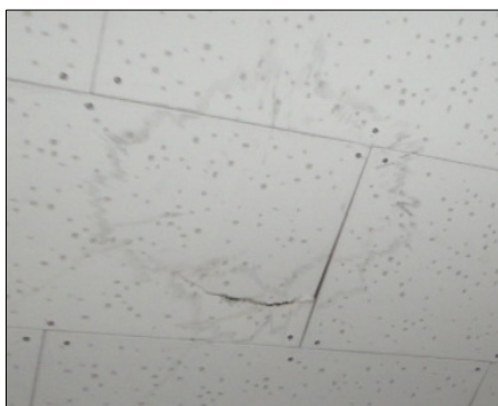
〈천장에 시공된 텍스(흡습 및 파손)〉
